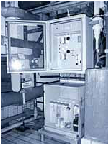
Přístroj PA-1 pro kontinuální monitoring rtuti ve vodě mokrého odlučovače v uhelné elektrárně
