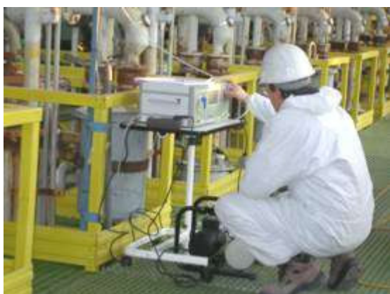
Kalibrace šestnáctibodového systému MMS v závodě na výrobu chloru a alkálií
