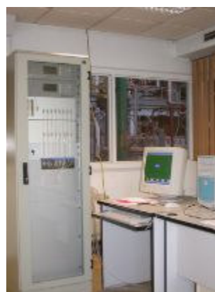
Systém MMS a řídicí počítač v kontrolní místnosti závodu na výrobu izotopů
