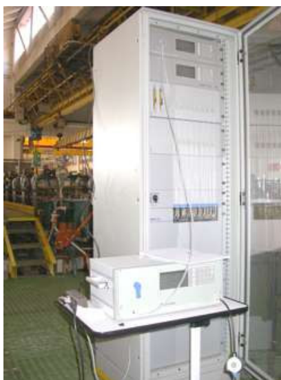
Kalibrace s přístrojem MC-3000 v provozních podmínkách
