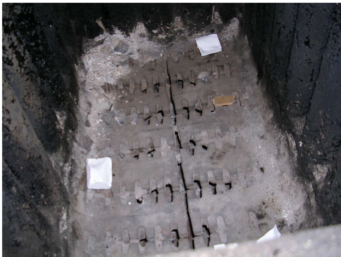
Obr. 2 Spalovací prostor kotle
